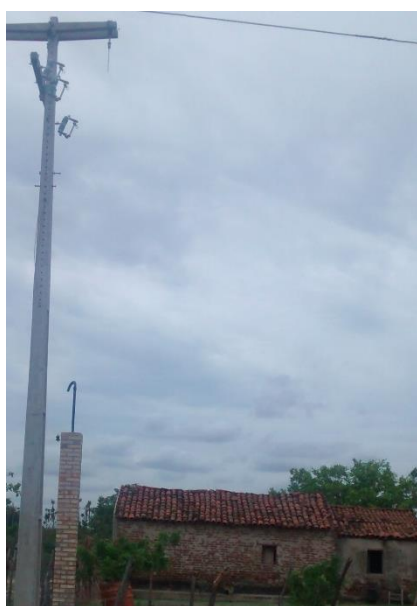
Figura 09: Rede elétrica instalada, com mureta pronta para recebimento da ligação de energia, 2015.
