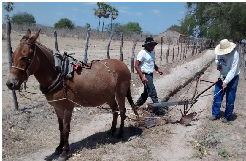
Figura 08: Escavação para implantação de adutora de água a partir do rio Umarí até a casa sede, 2014.
