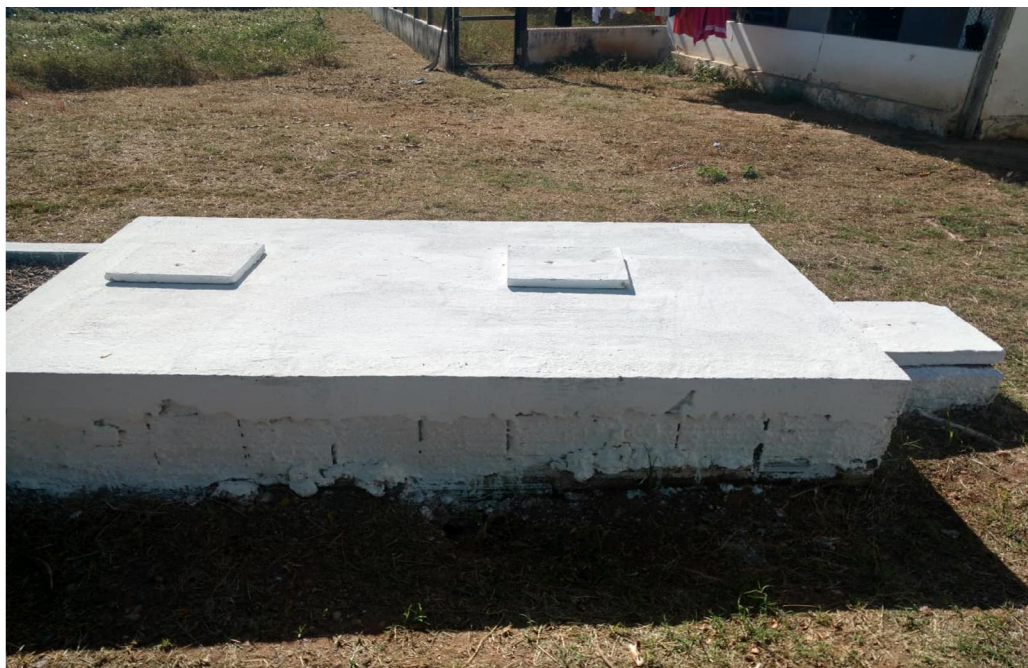
Figura 5. Vista lateral do tanque séptico.
