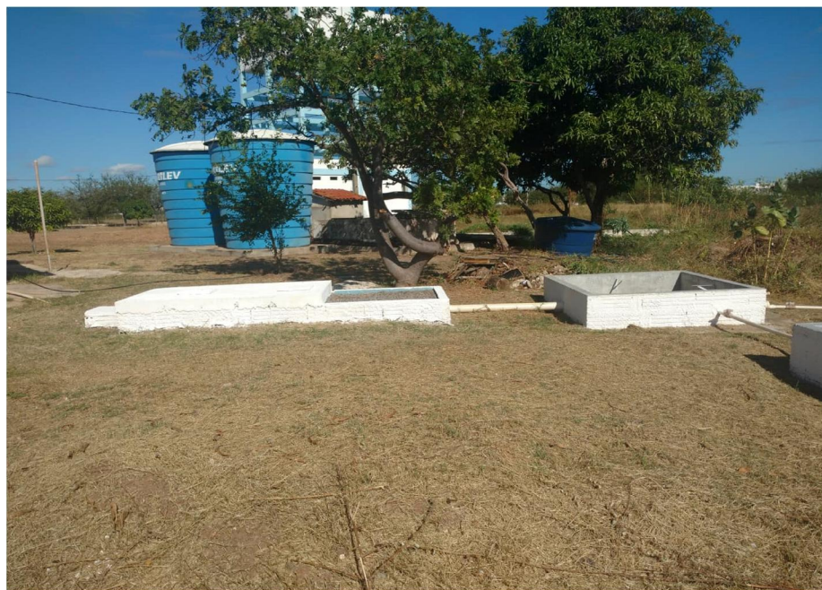
Figura 3. Vista lateral do sistema compacto de tratamento e uso agrícola e florestal de águas cinza.
