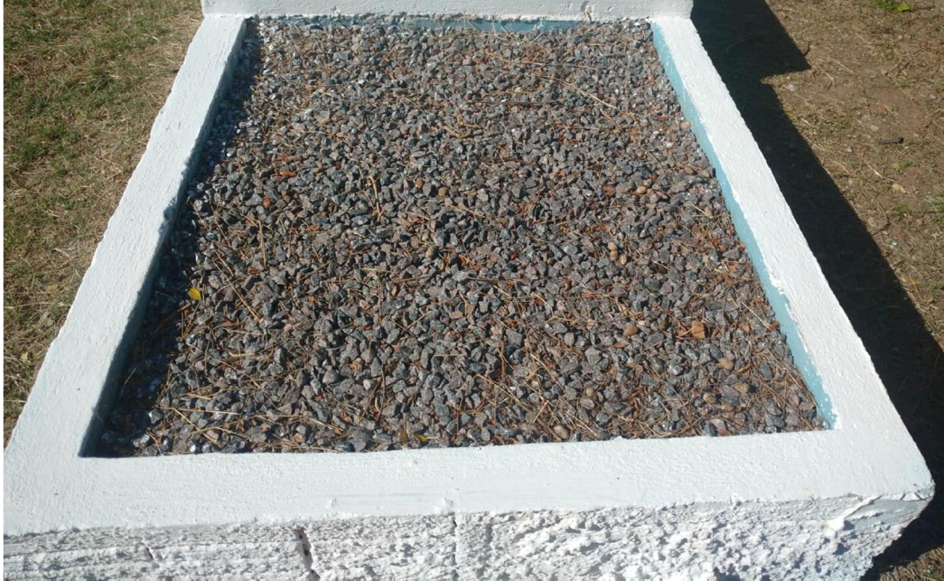
Figura 6. Vista superior do filtro anaeróbio.
