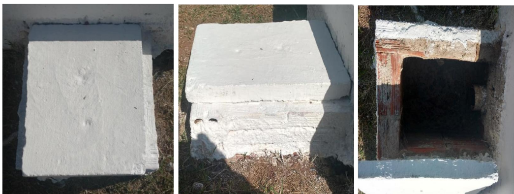
Figura 4. Vistas do tanque de equalização.
